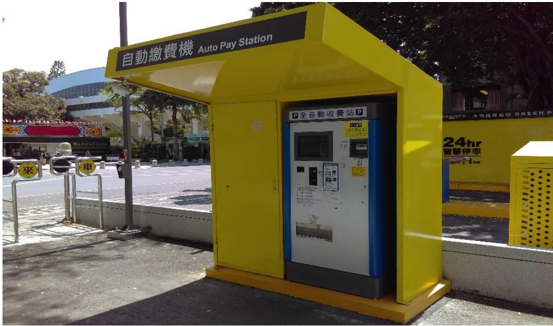
圖 14 停車場辨識設備及 4G 通訊模組等智慧停車管理設備
